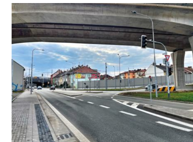
Křižovatka 5.09 Karlova – Provozníkova, rekonstrukce světelné signalizace je součástí projektu Rozvoj ITS v Brně, 2. etapa.
