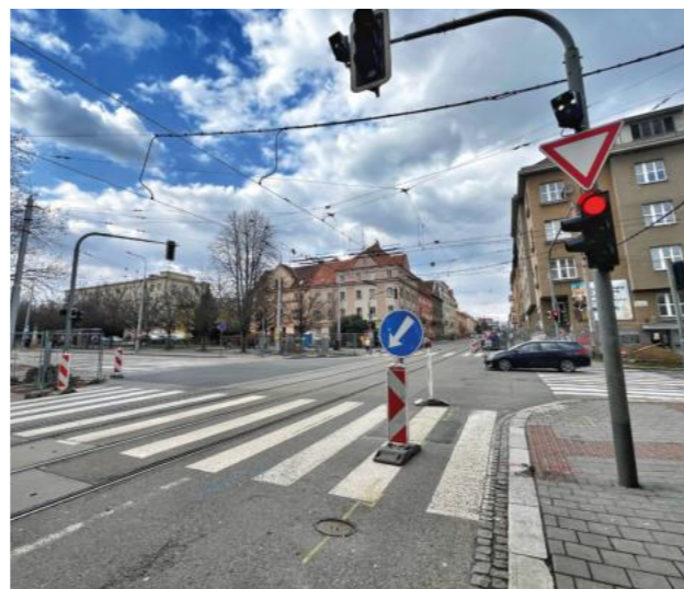
Křižovatka 7.17 Purkyňova – Skácelova, rekonstrukce světelné signalizace je součástí projektu Rozvoj ITS v Brně, 3. etapa.
